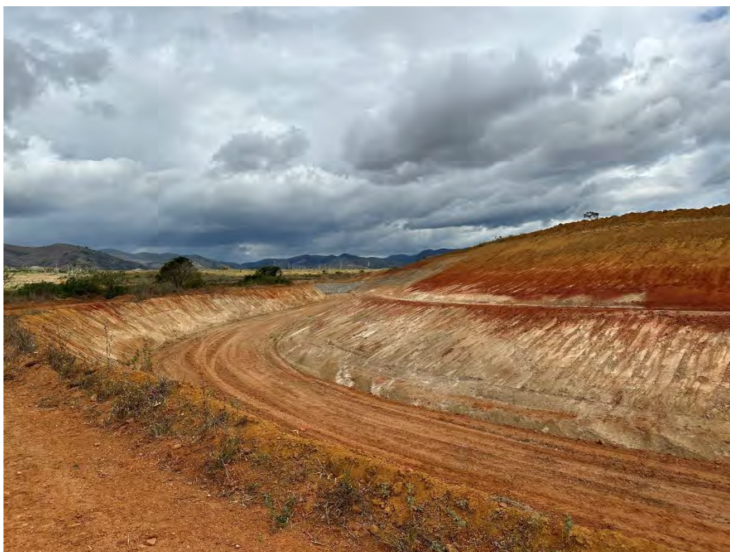
Foto 16 – Canal extravasor – Taludes reescavados, com inclinação que favorece a cobertura vegetal. Não há assoreamentos.
