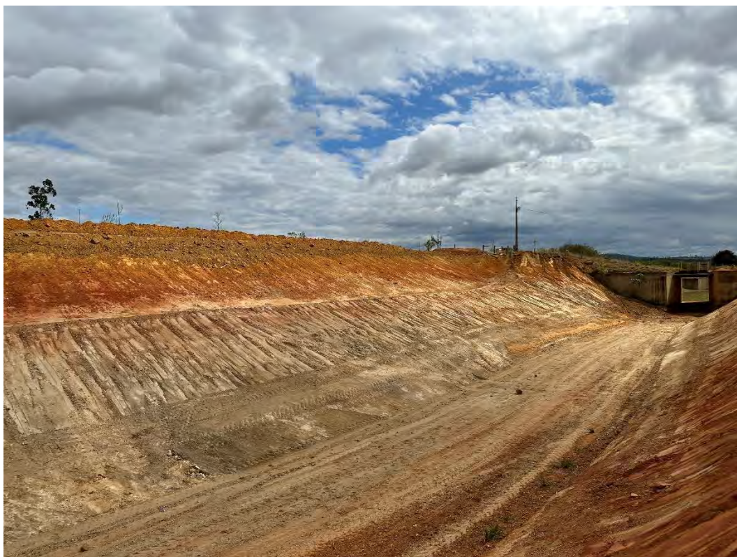
Foto 17 – Canal extravasor – Taludes reescavados, com inclinação que favorece a cobertura vegetal. Não há assoreamentos.
